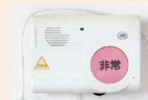
緊急呼出装置
