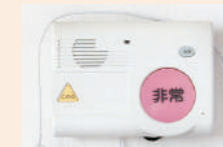
緊急呼出装置
