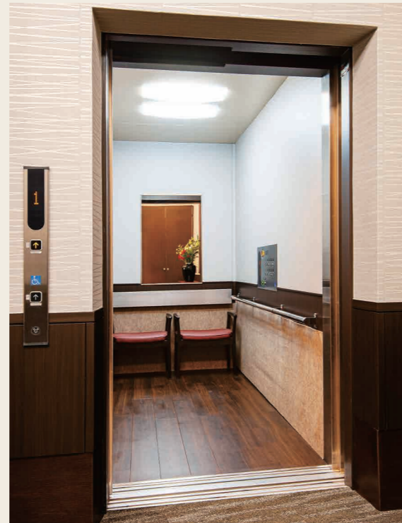
ストレッチャー対応型エレベーター(令和3年4月撮影)
