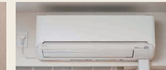
8 冷暖房エアコン
