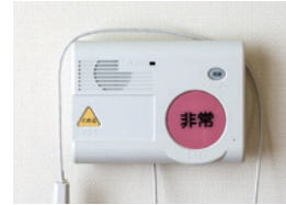
緊急呼出装置
