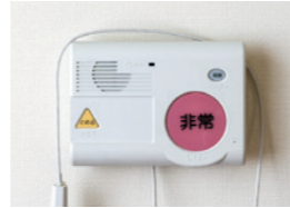
緊急呼出装置
