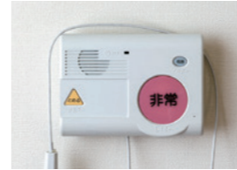
緊急呼出装置
