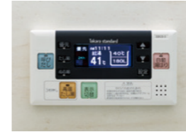
浴室給湯リモコン
