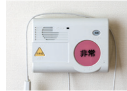
緊急呼出装置
