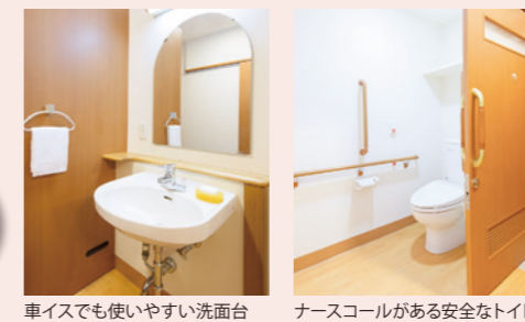
車イスでも使いやすい洗面台 ナースコールがある安全なトイレ
