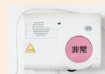
緊急呼出装置
