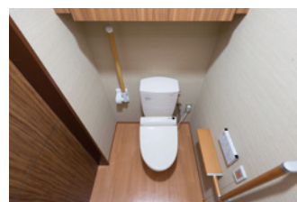
通常のトイレ（3・4階）
